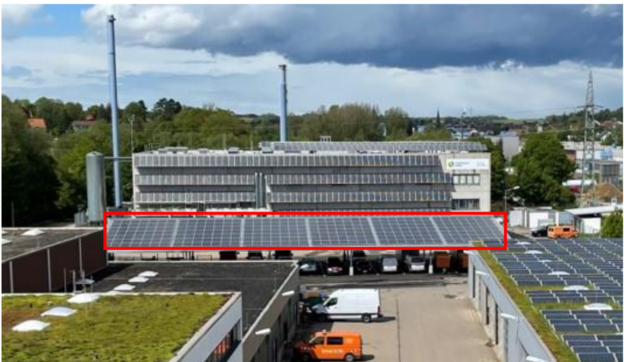
PV-Anlage auf Carport der Stadtwerke, Im Hasennest, - 99 kwp
